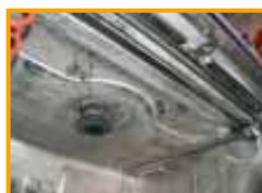
Spülkammer mit starkem Kalkbefall
